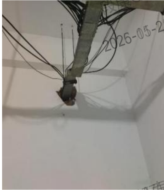
图 4-9 防火封堵现状图
