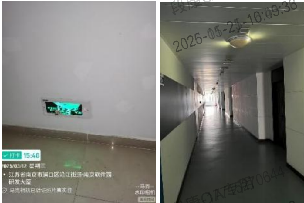
图 4-13 疏散指示灯及应急照明现状图
