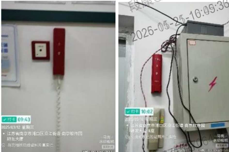
图 4-15 消防电话现状图
