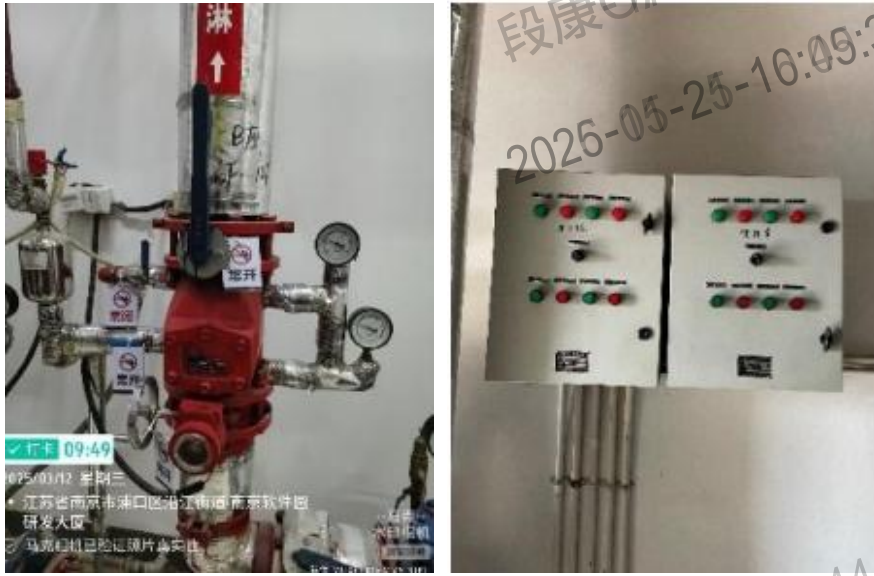
图 4-11 消防水泵及系统现状图
